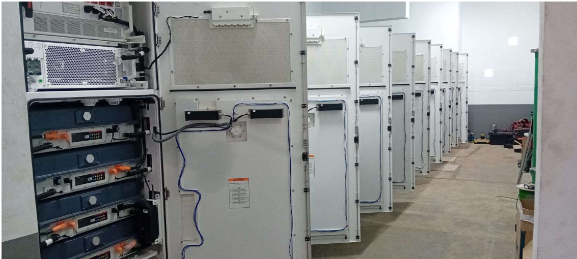
SALA 9 BATERÍAS POWERSTACK ST225
