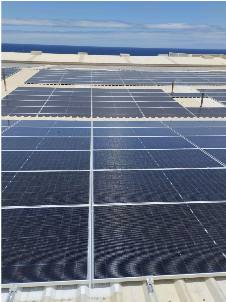
INSTALACIÓN GENERACIÓN VISTA GENERAL
