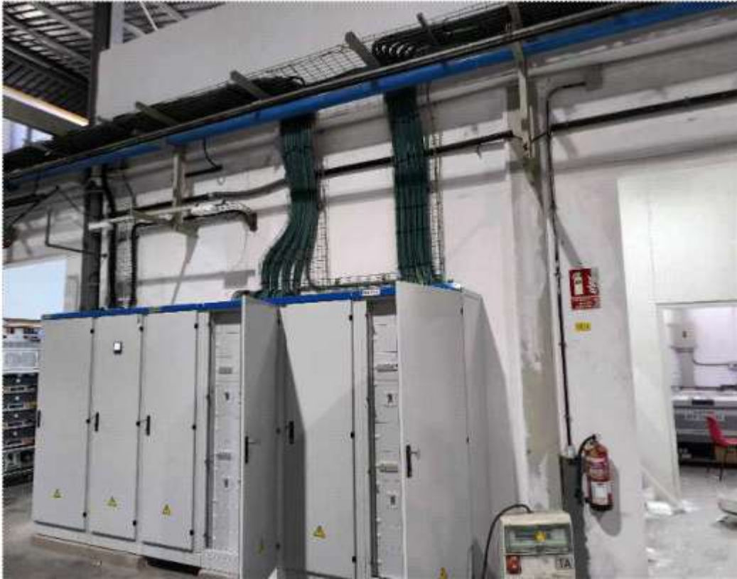
CUADRO GENERAL BT FOTOVOLTAICA Y ACUMULACIÓN
