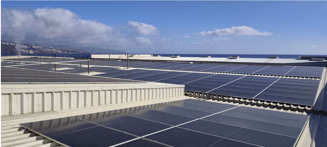
PLANTA FOTOVOLTAICA SOBRE CUBIERTAS NAVES
